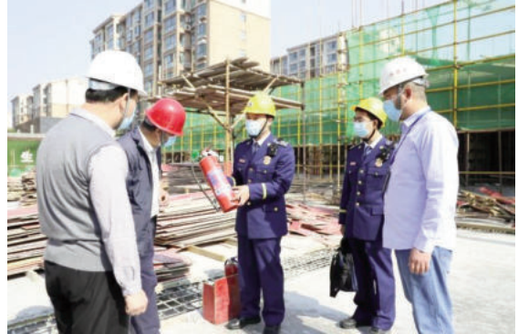
Thanh tra ngẫu nhiên thiết bị phòng cháy chữa cháy trong quá trình thi công công trình xanh tại tỉnh Hà Nam
