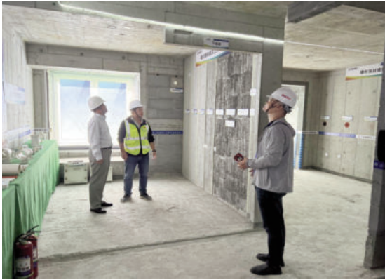
Tích cực đẩy mạnh nghiệm thu, kiểm tra thiết kế hệ thống phòng cháy chữa cháy theo bản vẽ thi công
