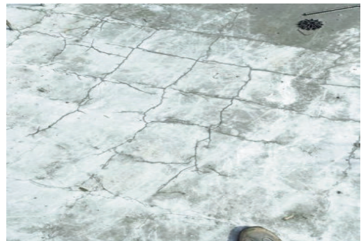
Các vết nứt trên tấm bê tông nguyên khối, thường xuất hiện tại các kết cấu công trình hoạt động trong điều kiện môi trường xâm thực
